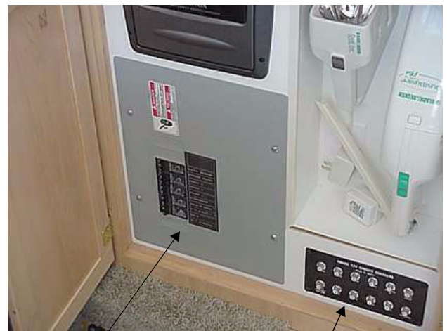
110-Volt AC Breakers
