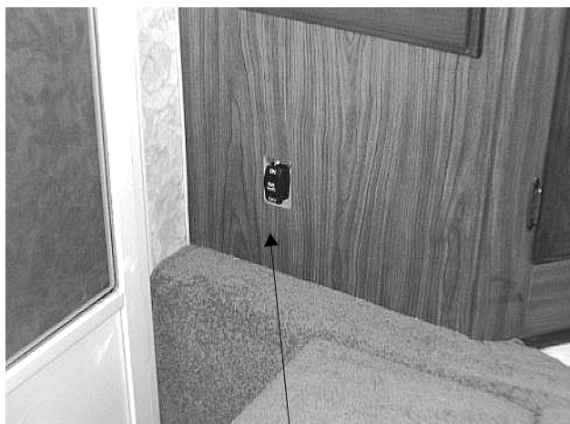
Aux. Battery Switch
